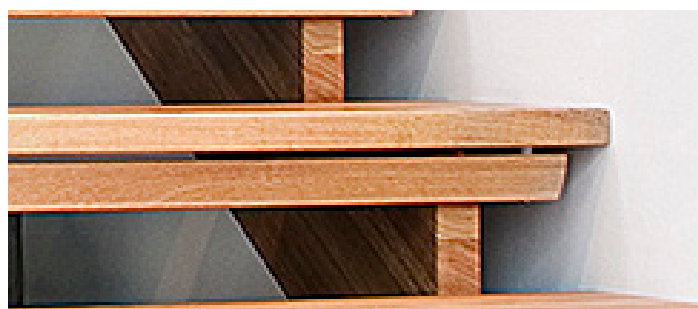
I en öppen trappa monteras en list under varje plansteg för att förhindra att barn kan tränga sig igenom och fastna.
